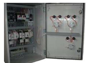
1003124 Tablero eléctrico para 1, 2, 3 Y 4 Ascensores
