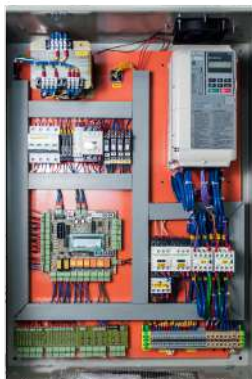
Cuadro de control con VVVF Yaskawa V1000 Saitek 14, Saitek 7
